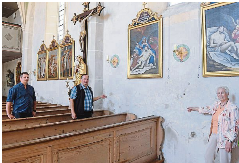
Feuchte Mauern, kaputtes Dach: Die Oberwarngauer Pfarrkirche St. Johann Baptist hat eine Generalsanierung dringend nötig. Pfarrer Gottfried Doll (M.), Thomas Engl (Kirchenverwaltung) und Kirchenpflegerin Anni Bichler weisen auf unserem Bild auf die Wandschäden im Innenraum hin. FOTO: THOMAS PLETTENBERG
