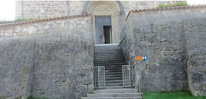
Die Friedhofsmauer im Bereich des Haupteingangs zur Basilika in Altenstadt muss saniert werden. FOTO: KINDLMANN
