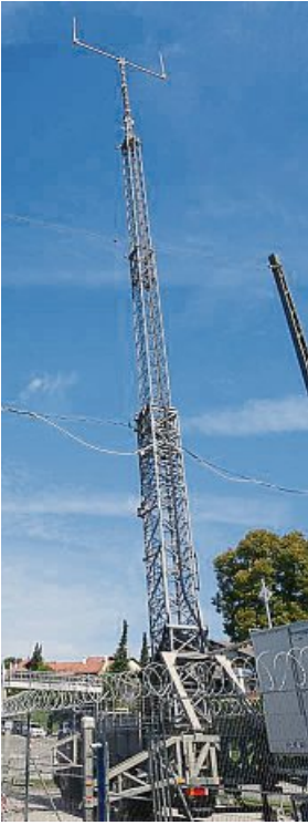
Umstritten und unschön: der von Stacheldraht umgebene Behördenfunkmast. FOTO: SALA
