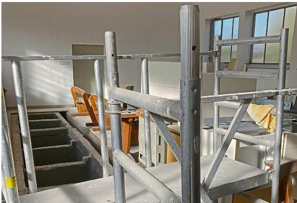
Früher befand sich eine Umspannanlage am Sieverts Kamp, künftig hat der Heimatverein hier einen Standort inklusive Versammlungsraum.
