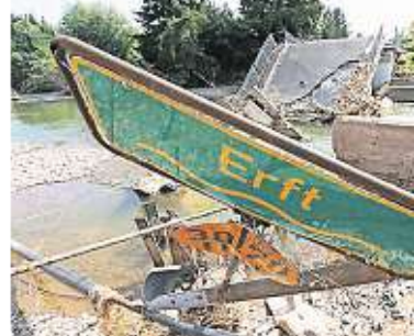
Diese Brücke über die Erft wurde durch die Flut zerstört. FOTO: YOUNG/DPA
