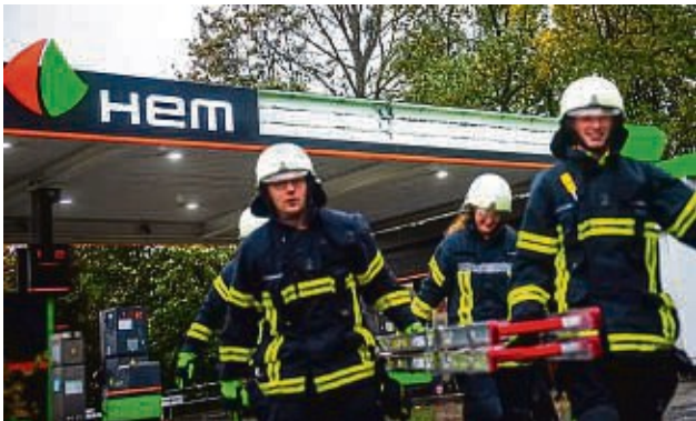
An der HEM-Tankstelle lösten sich Teile des Daches.
