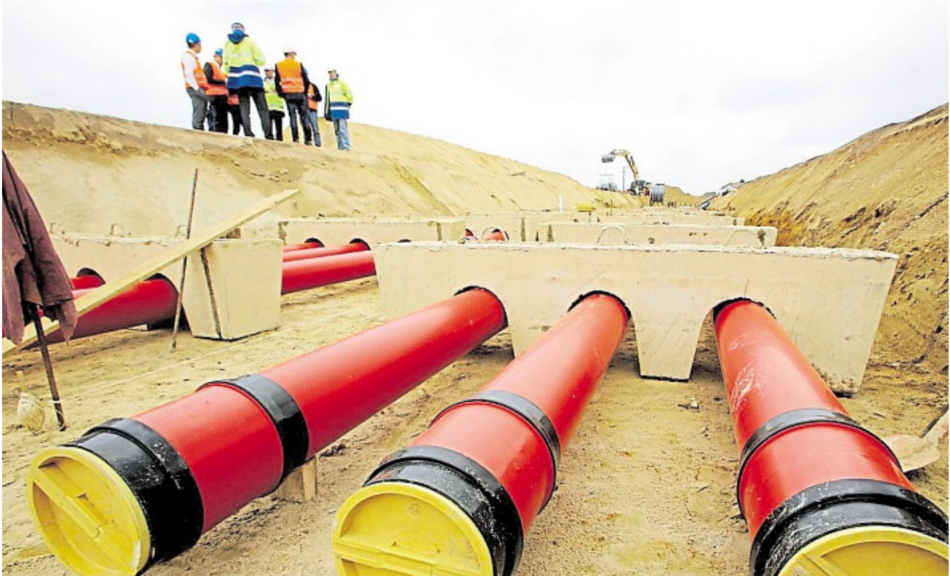
Die geplanten 525-kV-Gleichstromleitungen führen auch durch das Osnabrücker Land und/oder das Emsland. Die gute Nachricht: Für Korridor B gibt der Gesetzgeber dem Erdkabel Vorrang. Das Bild entstand in Raesfeld. Foto: dpa/Roland Weihrauch
