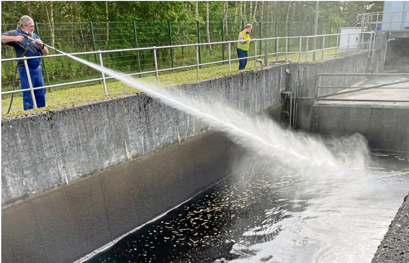
Reichlich Müll wurde am Sauerbruchkanal an der Kaspar-Grove-Straße in Alt-Marl verklappt. Wer kommt am Ende dafür auf? Die Allgemeinheit.
