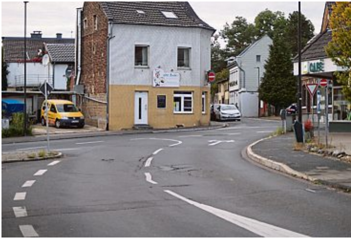
Auf der Kreuzung gibt es wegen einer tektonischen Störung viele Risse auf der Fahrbahn.
