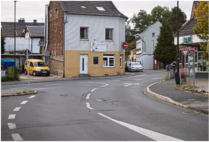
Auf der Kreuzung gibt es wegen einer tektonischen Störung viele Risse auf der Fahrbahn. Foto: Meisen
