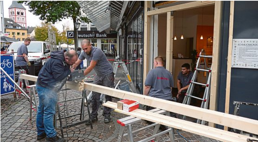
Schon am Nachmittag reparierten Handwerker die völlig zerstörte Tür notdürftig.
