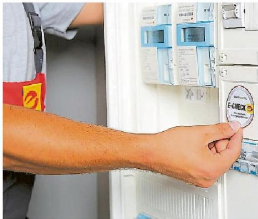
Nach einem festgelegten Kriterienkatalog überprüft der Fachmann elektrische Anlagen und dokumentiert die Sicherheit.
