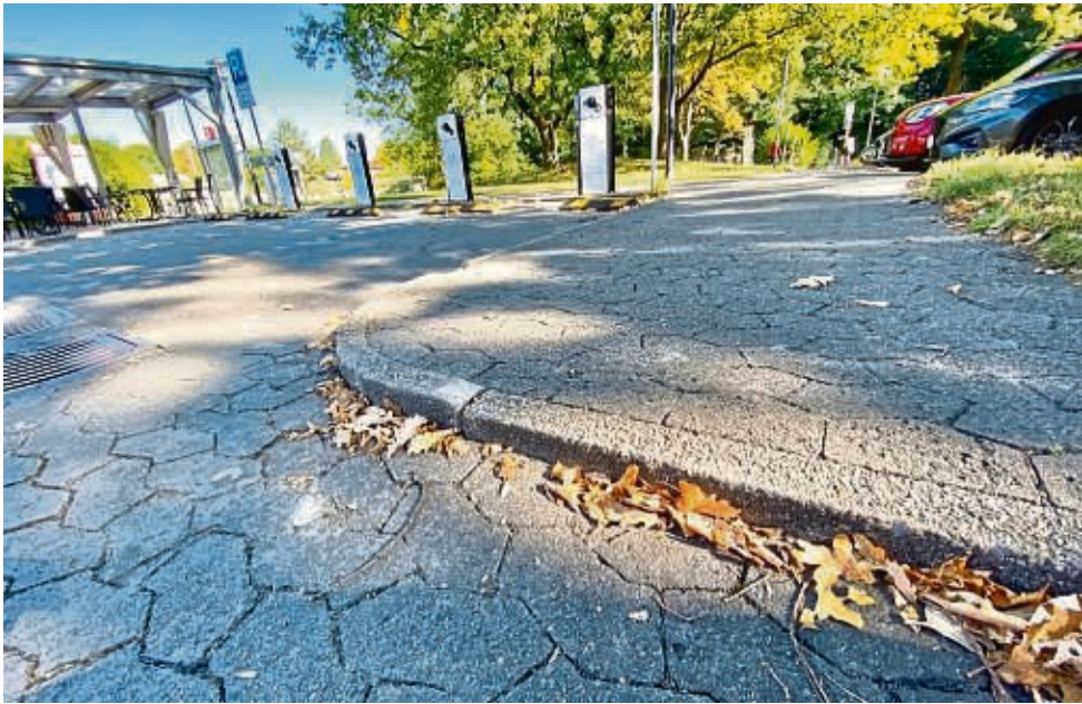
Die Bordstein-Schwelle zum Fußweg sollte abgesenkt werden.
