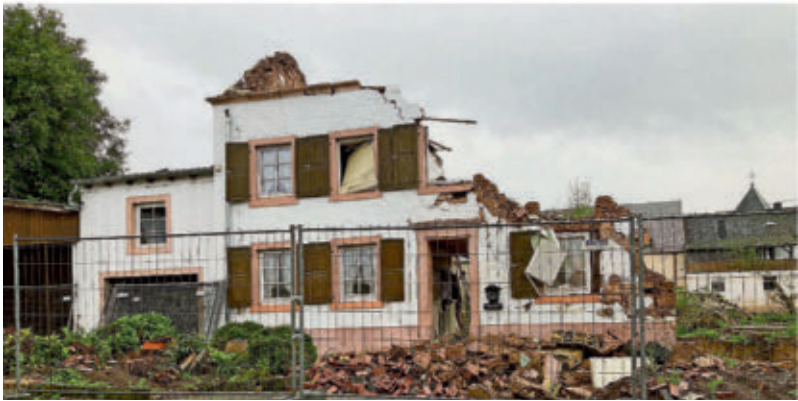
Viel steht nicht mehr: Das ehemalige Zuhause der Wenzels in Brecht an der Prüm.
