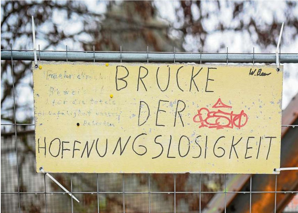
Die Menschen im direkten Umfeld leiden schon seit Jahren unter der maroden Brücke. Jetzt ist der Zustand so desolat, dass täglich tausende Fahrgäste und rund 50 Güterzüge betroffen sind. FOTO: ULLA MICHELIS / FUNKE FOTO SERVICES
