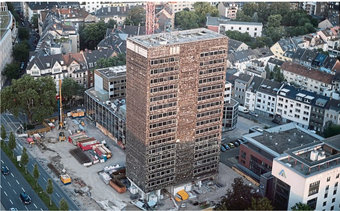
Das bestehende Hochhaus soll einem Neubau weichen. Der Abriss verzögert sich durch den Asbestfund. Foto: Max Grönert
