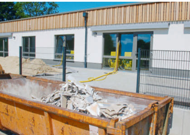
Bereits im Juli trat während der Bauphase ein Wasserschaden in der Kita am Hollandsweg auf.
