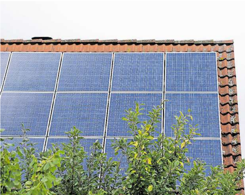
Aachen macht ernst: Für Neubauten soll bald eine Solardachpflicht gelten.
