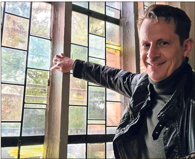
Projektleiter Steffen Holtmann von der Firma Glasmalerei Otto Peters zeigt auf eine Stelle in einem Kirchenfenster, an der der Mörtel aus der Fensterfuge gebrochen ist.
