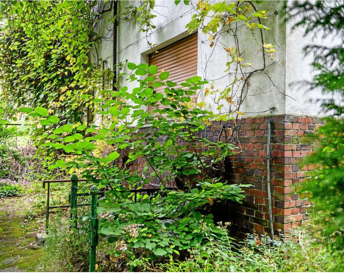
Das leerstehende Haus am Sanders Hof lädt einige Jugendliche zu gefährlichem Unsinn ein. Dort gab es auch schon Brandstiftung.
